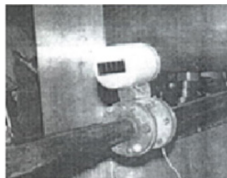
Рис. 4. Загальний вигляд витратоміру, змонтованого на газоперекачувальному агрегаті ГТК 10-2
